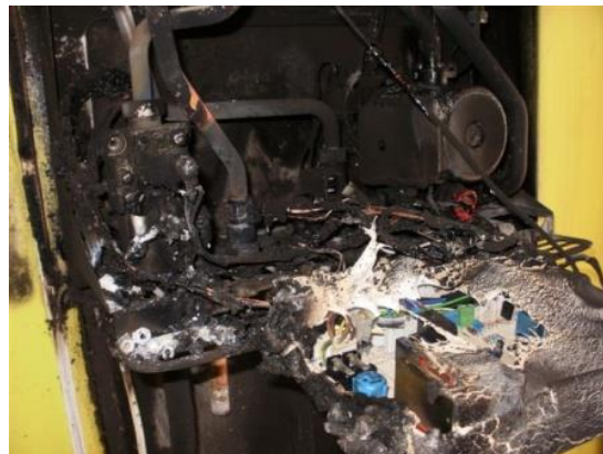
Foto 7 – Vana de gaz este arsă în întregime, dar afectată de flacără este și zona de sub centrală
