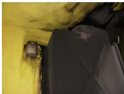
Foto 8 – Detector de scăpări de gaz metan lângă centrala termică
