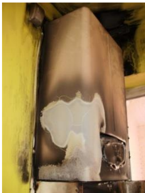
Foto 1 – Centrala afectată de incendiu
