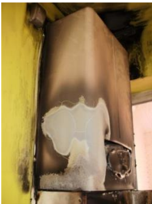
Foto 9 – Zona din partea stângă a centralei este mai afectată de incendiu
