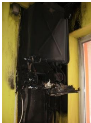
Foto 3 – Zona afectată de incendiu
